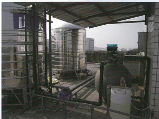
圖18 人工濕地淨化後的水經砂濾及加氯消毒使能符合沖廁用途。
