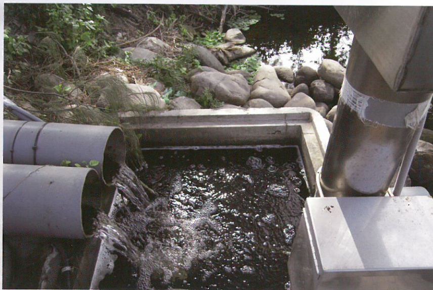
圖8 FWS濕地出口：人工濕地淨化後的清澈水由此處流至生態池，右方為流量及水質即時監測設備。
